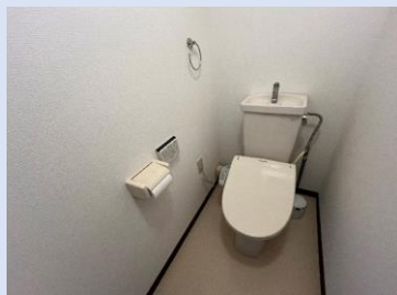
温水洗浄便座付きトイレ
