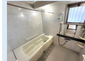
1620サイズの広々バスルーム 浴室乾燥機を備えています
