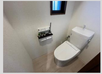
温水洗浄便座付きトイレ
