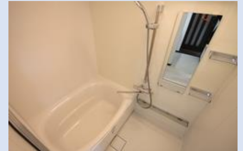
新品の浴室は、爽快快適！浴室乾燥機付
