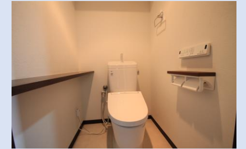
温水洗浄便座付きトイレ
