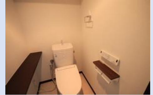
温水洗浄便座付きトイレ
