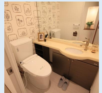
温水洗浄便座付き 多機能トイレ
