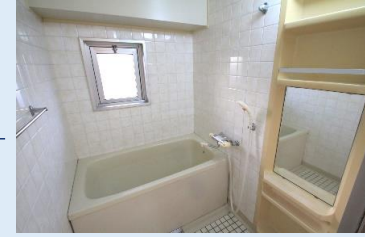
一日の疲れを癒す、快適バスルーム 換気窓を設けています。
